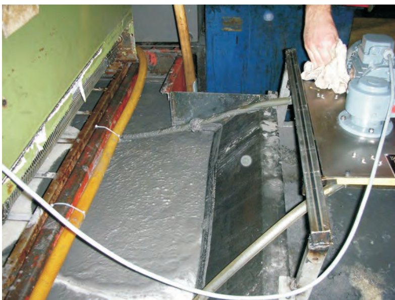
Déshuiler à tuyau W40 à bassin avec refroidissement
